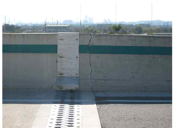
S1 중분대 접속부 A1측 파손
