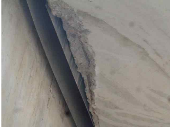
S4 파손 및 철근노출 (0.2m×1.0m)
